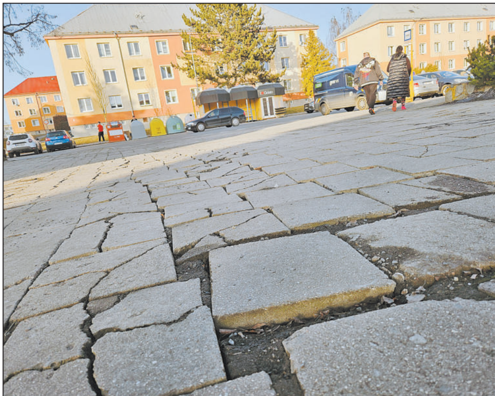
STAV dlažby před obchodním komplexem na Stalingradu je v tristním stavu a již dlouho volá po opravě.
