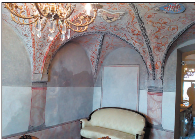
VYBOULENÁ a opadávající omítka v renesanční komnatě je dle majitelů Veliše důsledkem nezajištěné sousední stavby. Foto: Lenka Kopčáková
