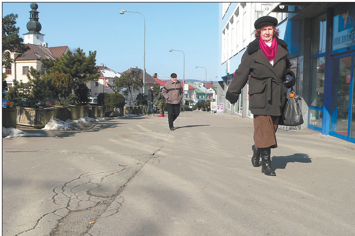
ZVLNĚNÝ popraskaný asfalt a nečekané překážky na chodníku podél obchodních domů na náměstí už volají po řešení.
