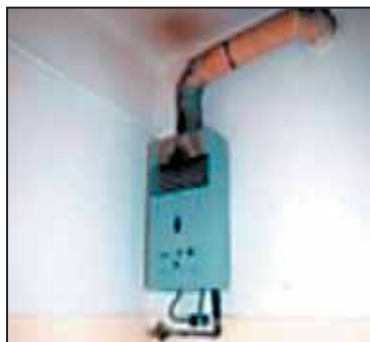
STOPY ZNEČIŠTĚNÍ v důsledku úniku spalin
