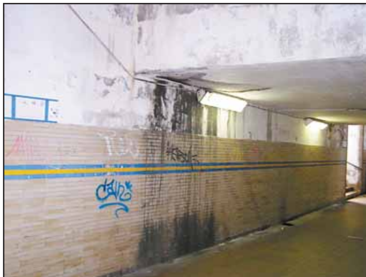
TAKÉ podchod na jednotlivá nástupiště na žďárském vlakovém nádraží čeká ještě na úpravu. Foto: Antonín Zvěřina
