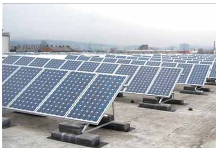
FOTOVOLTAICKÁ střešní elektrárna v praxi. Foto: archiv P. O. Poliklinika
