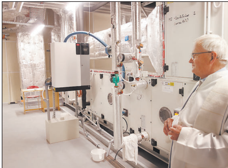
PROHLÍDKU vzduchotechniky nad operačními sály si nenechal ujít P. Kříž.
