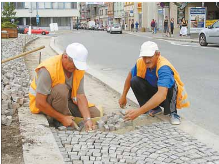
CHODNÍK na Karlově náměstí v Třebíči prošel rekonstrukcí. Vyžádal si zhruba sto tisíc korun. Špatný stav zavinila posypová sůl a tlak zadráždění plochy náměstí. Současná úprava náměstí pochází z poloviny 60. let.
