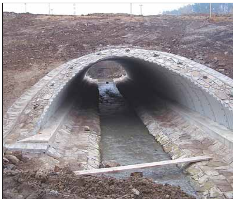
TAKOVÝ tunel se objevil v trebičské čtvrti Borovina. Naštěstí jím neproudí peníze, nýbrž voda Stařečského potoka.
