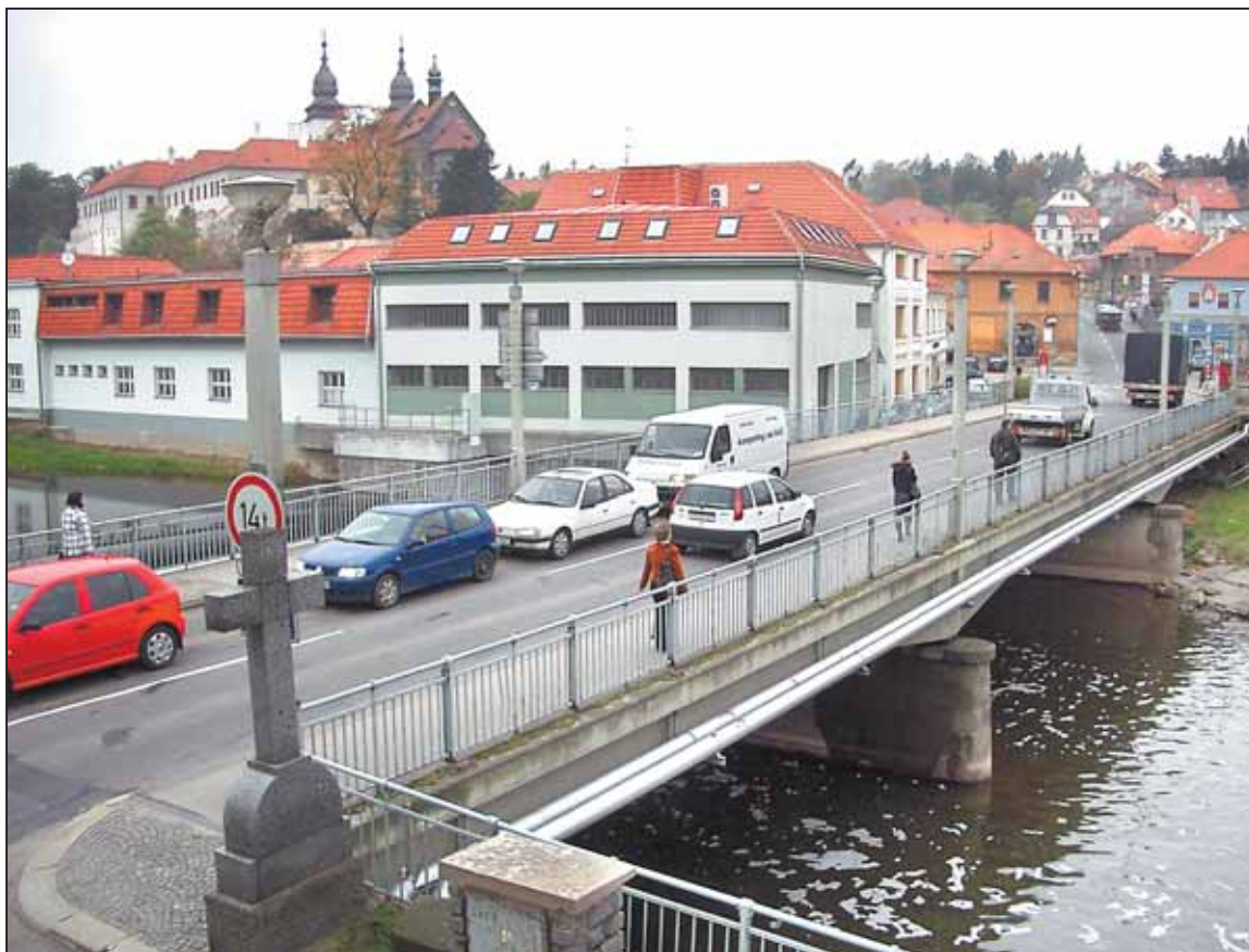
DNY tohoto frekventovaného železobetonového mostu přes řeku Jihlavu jsou prakticky sečteny. Kvůli havarijnímu stavu ho čeká demolice a na jeho místě bude postaven nový. Foto: Luboš Janoušek
