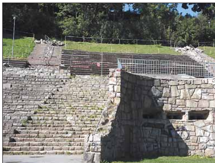
PRŮCHOD AMFITEÁTREM. Radnice zahájila připravované opravy schodišť v areálu letního amfiteátru v lesoparku Heulos. Práce na opravě schodišť a tedy i uzavření části areálu amfiteátru potrvá nejdéle do konce listopadu. Dodavatel odstraní současná poškozená schodiště, provede výkopové práce, vybuduje nové základy, roznášecí desku s výztužemi, nové kamenné stupně a opraví zábradlí. Cena 1,4 milionu bez DPH.
