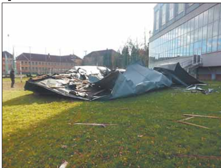
ČÁST střechy na bazénu Rošického nevydržela listopadový poryv větru a porouchala se k zemi. Foto: archiv MMJ
