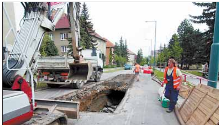
PŘÍČINOU propadu vozovky v Hamerníkově ulici byla vadná kanalizace.
