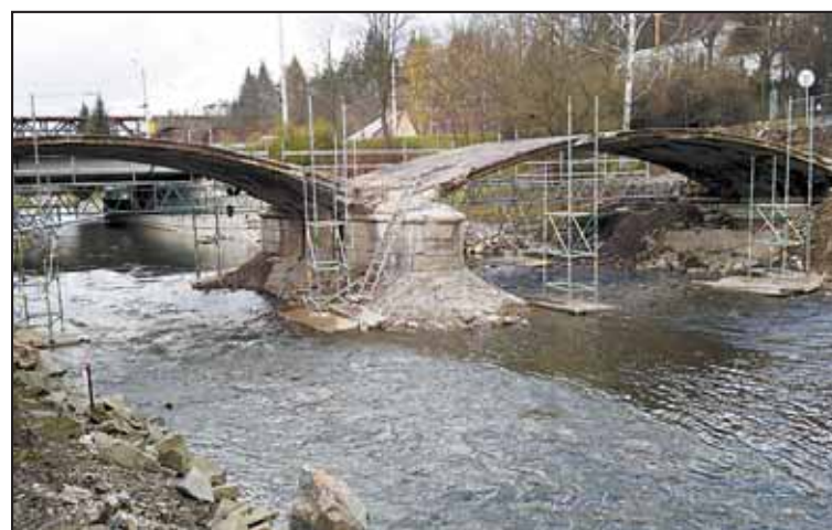
MOST U JÁNŮ prochází rozsáhlou rekonstrukcí. Radikální zásah až „na kost“ vyžadoval jeho neuspokojivý stav na hranici havárie.
