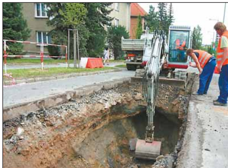
PŘÍČINOU propadu vozovky v Hamerníkově ulici byla vadná kanalizace.
