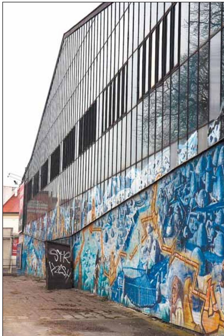
Jižní stěna Horáckého zimního stadionu má prosklenou část, která je v havarijním stavu a hrozí vypadnutí skel.
